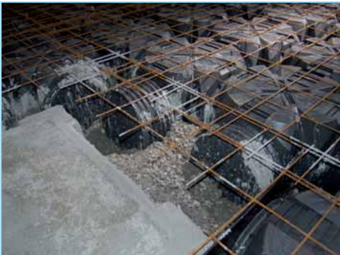
fig. 23) PADOVA • Refrigeration cell 5970 m 2
