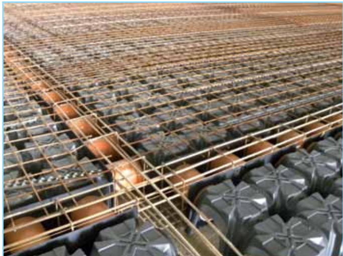
fig. 24) PADOVA • Refrigeration cell 5970 m 2
