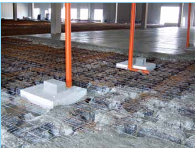
fig. 25) TORINO • Refrigeration cell 5310 m 2
