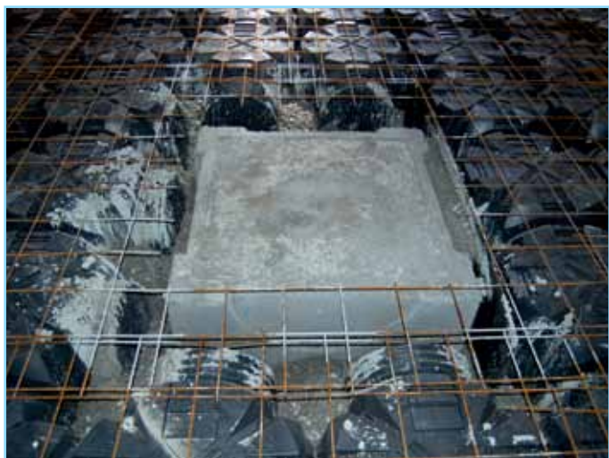
fig. 26) TORINO • Refrigeration cell 5310 m 2
